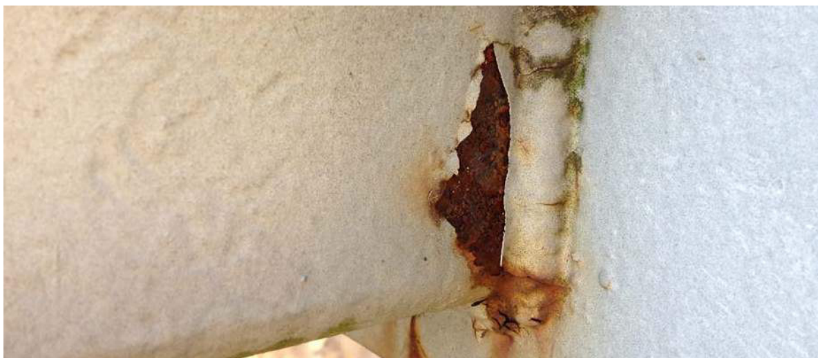
Abbildung 13: Beschichtungsschäden an einer nicht ordentlich gereinigten Schweißnaht
