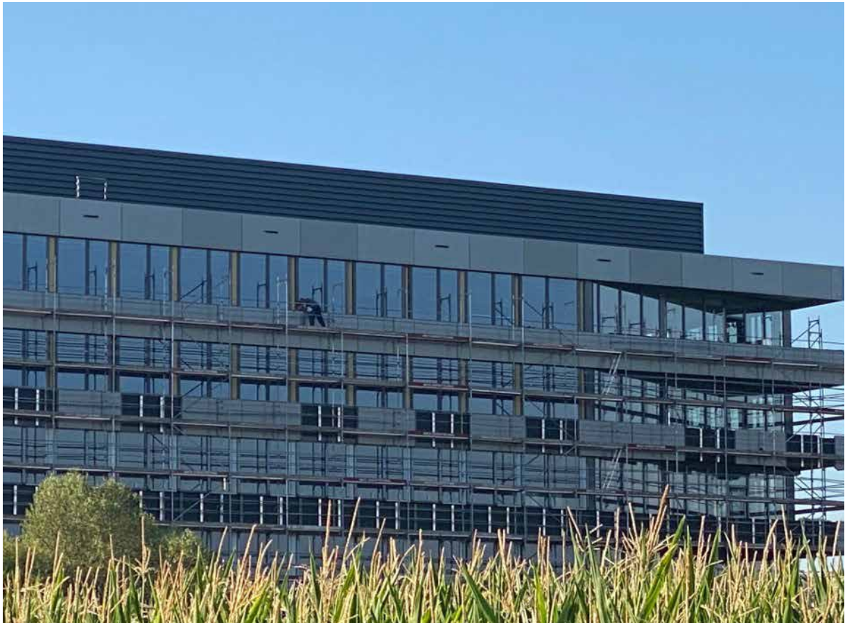
Abbildung 3: Farbtonabweichung an einer Fassade
